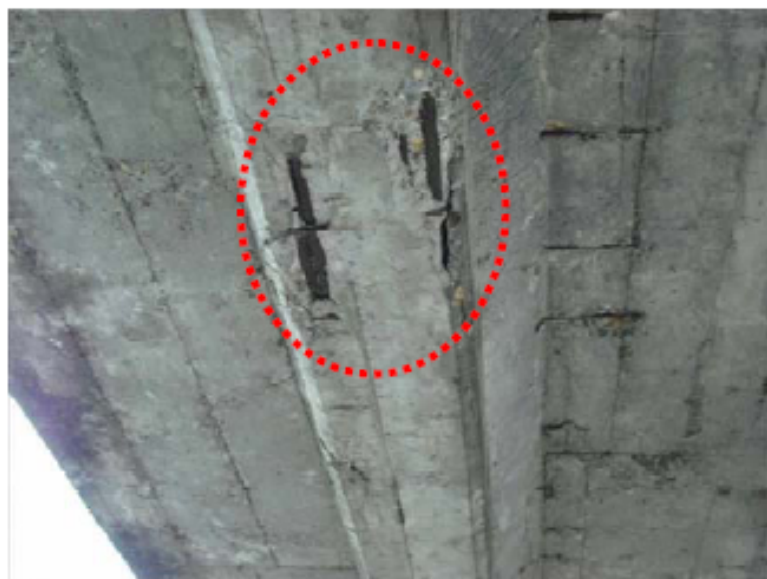
主桁の鉄筋露出
