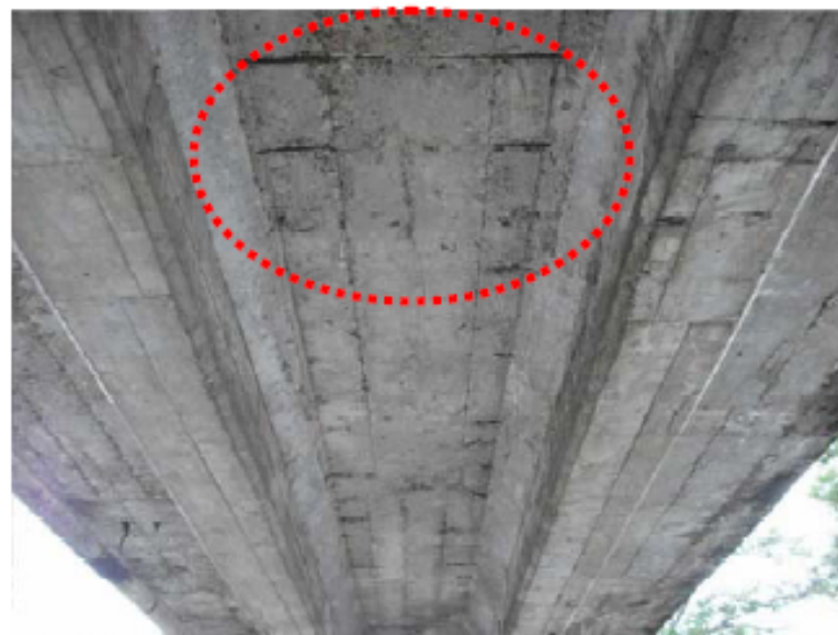
床版の鉄筋露出
